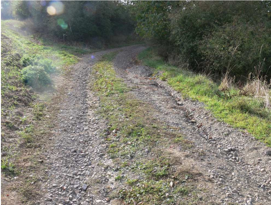
Abbildung 2 Erosion im Schotterweg
